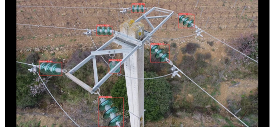
FIGURE 1 – Exemple de détection d'isolateurs par Yolov5m6.
