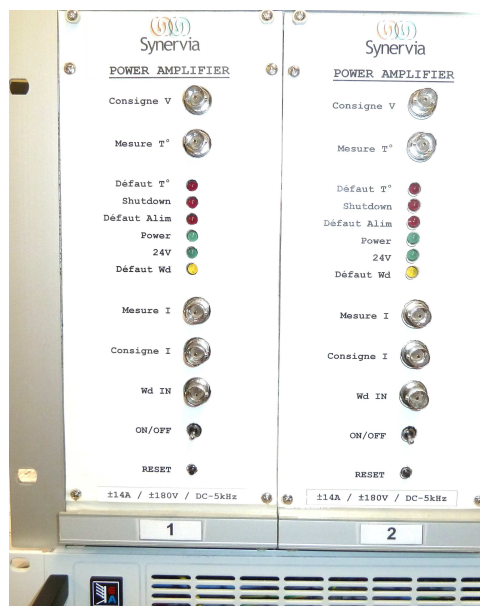
FIGURE 4 – Photo du rack avec deux amplificateurs
